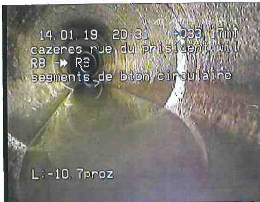
Photo: 11_11_72_A.jpg, N° support: 2-14012018 c_7, 00:05:08 33,17m, Niveau d'eau, aspect discontinu niveau exprimé en pourcentage du diamètre: 1 %
