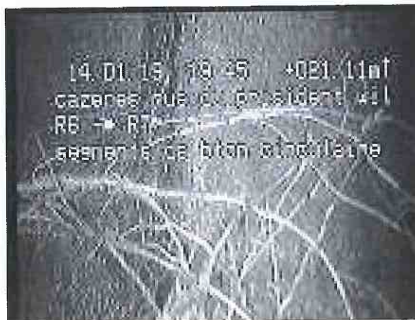
Photo: 8_8_32_A.JPG, N° support: 2-14012018 c_7 21,11m, Ensemble complexe de racines à 4 h. réduction de la section transversale: 3 %
