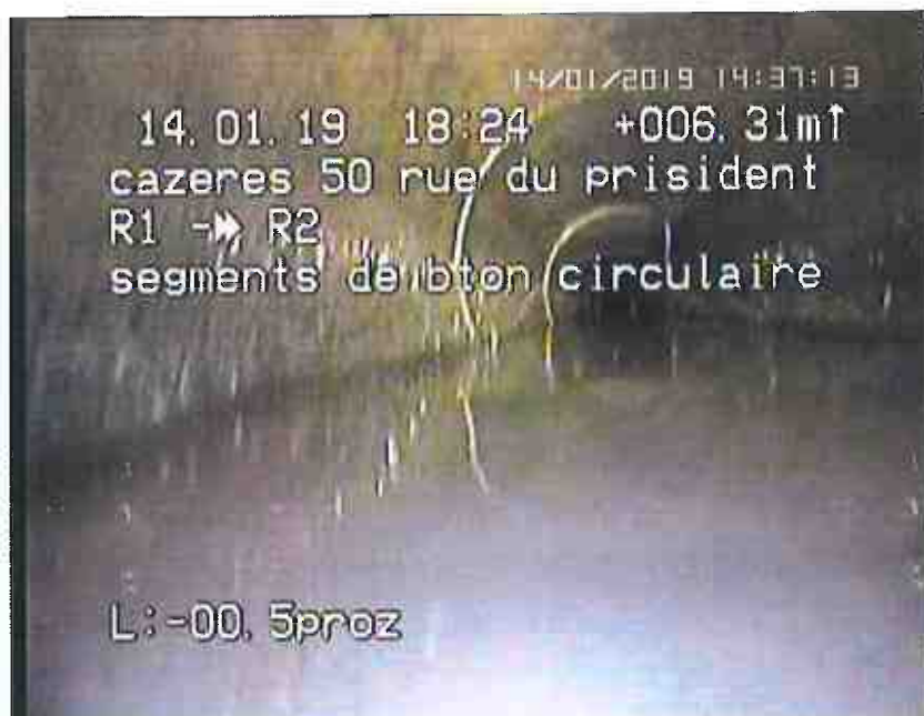
Photo: 2_2_66_A.jpg, N° support: 2-14012018 c_7, 00:00:54 6,3m, Niveau d'eau, aspect discontinu niveau exprimé en pourcentage du diamètre: 20 %
