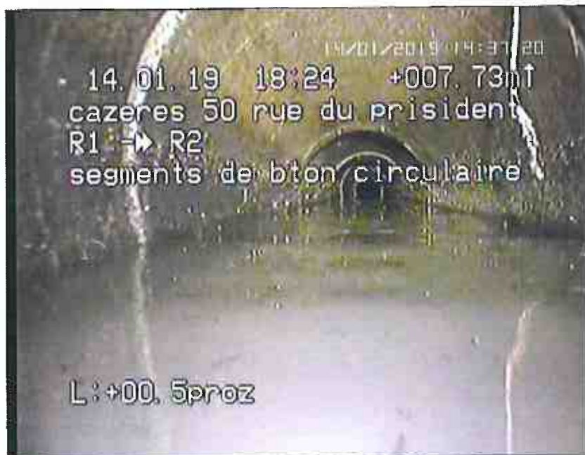
Photo: 2_2_65_A.jpg, N° support: 2-14012018 c_7, 00:01:01 7,72m, Radicelles à 1 h. réduction de la section transversale: 1 %
